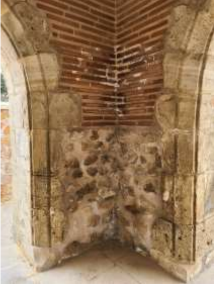
Görsel 16. Erenler Türbesi, moloz taştan inşa edilen kemer ayağı
